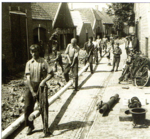
Aanleg van waterleiding aan de Huttenwal in Rijssen, 1936. De buis wordt in de geul getild. Bron: Archief gemeente Rijssen-Holten.
